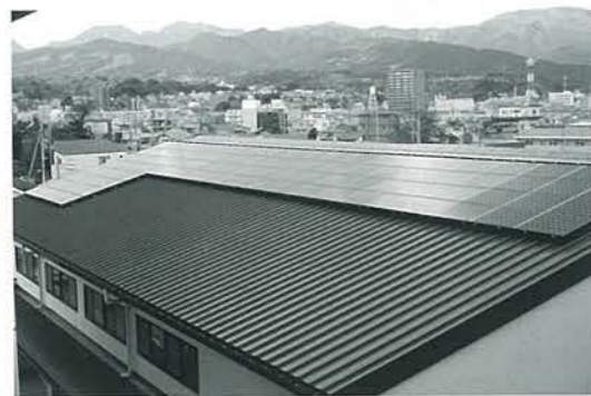
小田原市内小学校の太陽光発電設備
