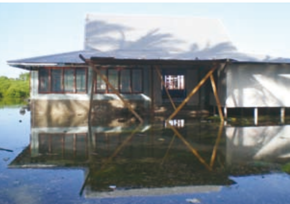
2009年3月、フォンガファール島にて。大潮時期に床上浸した家屋。満潮時には海水が地面から滲み出して島内を浸してしまう
