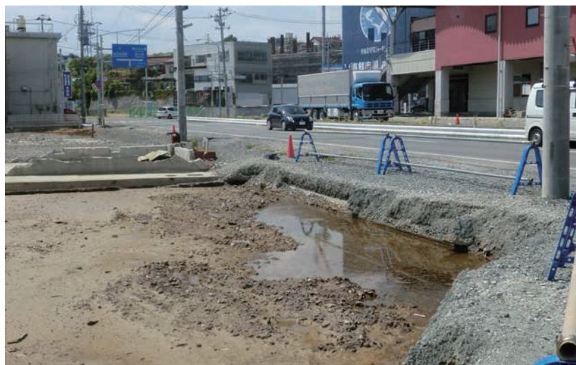
写真 11 地盤沈下の影響（市街地）
