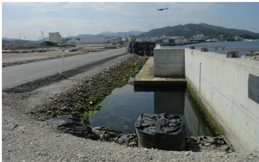
写真 10 地盤沈下の影響（海岸沿い）
