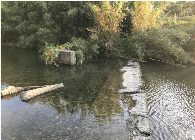
写真11 橋桁が落ちた沈下橋
