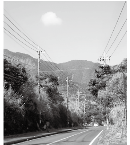
信じてもらえないのだが、道路の両側に九州電力が管理する配電線と町が管理する電線が並走している
