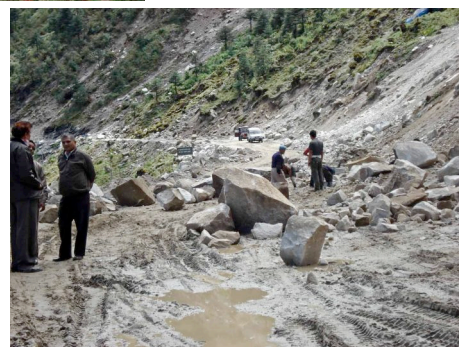
写真2 斜面崩壊による道路の復旧工事風景。アルナーチャル・プラデシュ、タワン近郊（3500 m）。2008年9月20日 宮本真二撮影。
