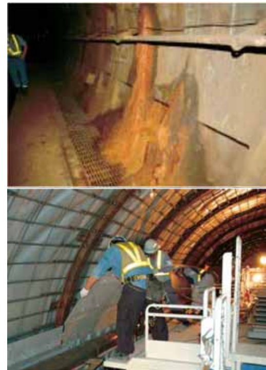
漏水 (総武快速線) (Nikkei Const., 2004)
