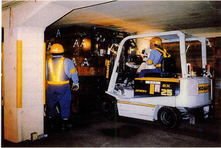
地下4階で行われている鉄板の設置作業。鉄板の重量は1枚あたり約2t (写真: JR 東日本)
