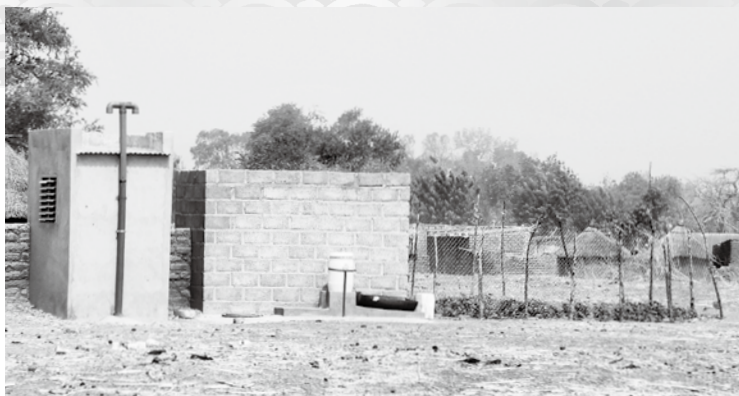
ブルキナファソに設置した資源回収型サニテーションのしくみ (伊藤竜生プロジェクト研究員撮影)
